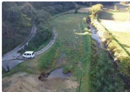
被災状況(ドローン撮影:斜俯瞰)
