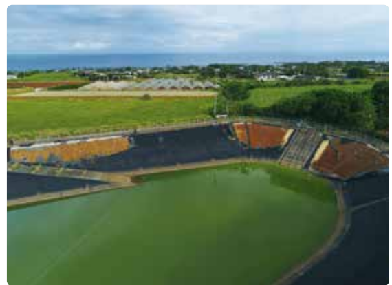
ため池の遮水シートの被災状況（和泊町）
