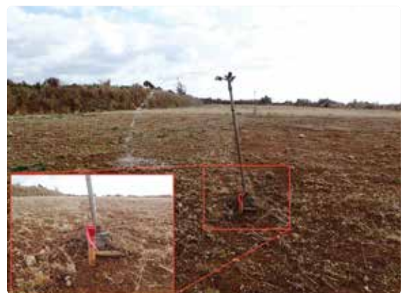
農業用施設（給水栓等）の被災状況（伊仙町）
