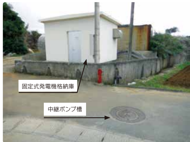
写真-1 固定式発電機格納庫及び中継ポンプ
