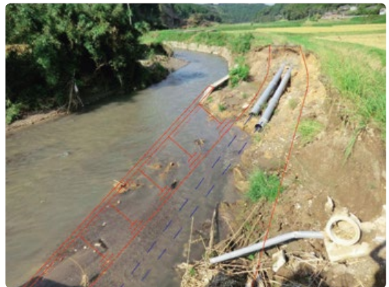
流出した農道とパイプライン
