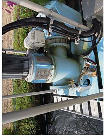
水車及び発電機
