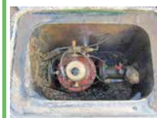
かんがい用水施設の老朽化（漏水）
