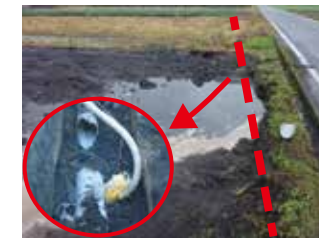
かんがい用水施設の老朽化（漏水）
