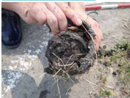
ポリ管：施工後15年経過
