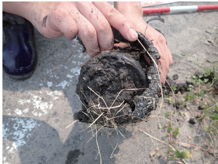
ポリ管：施工後15年経過
